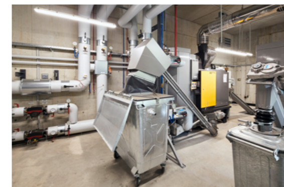
Die Biomasseanlage wird mit Holzhackschnitzeln aus umliegenden Wäldern betrieben.
